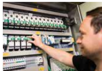
Dank des intelligenten Verbindungs- und Kommunikationssystems SmartWire-DT konnte der Verdrahtungsaufwand um rund 40% gesenkt werden
